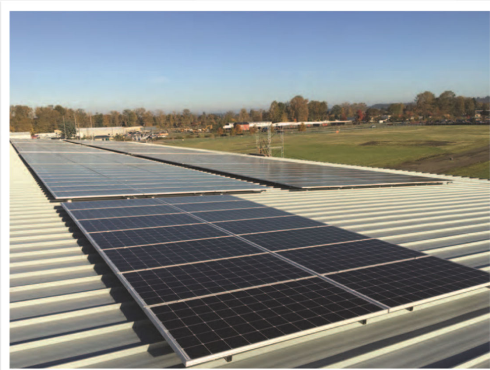
Salem AASF Solar Panels
